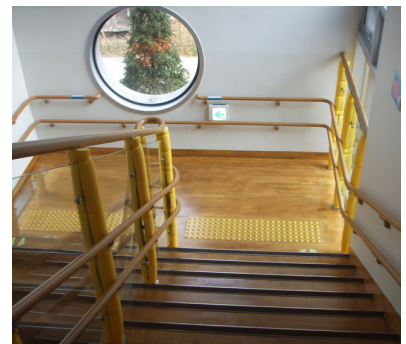
어린이집 계단 난간의 보조손잡이, 바닥논스립
